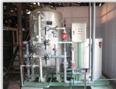
イオン交換樹脂塔
